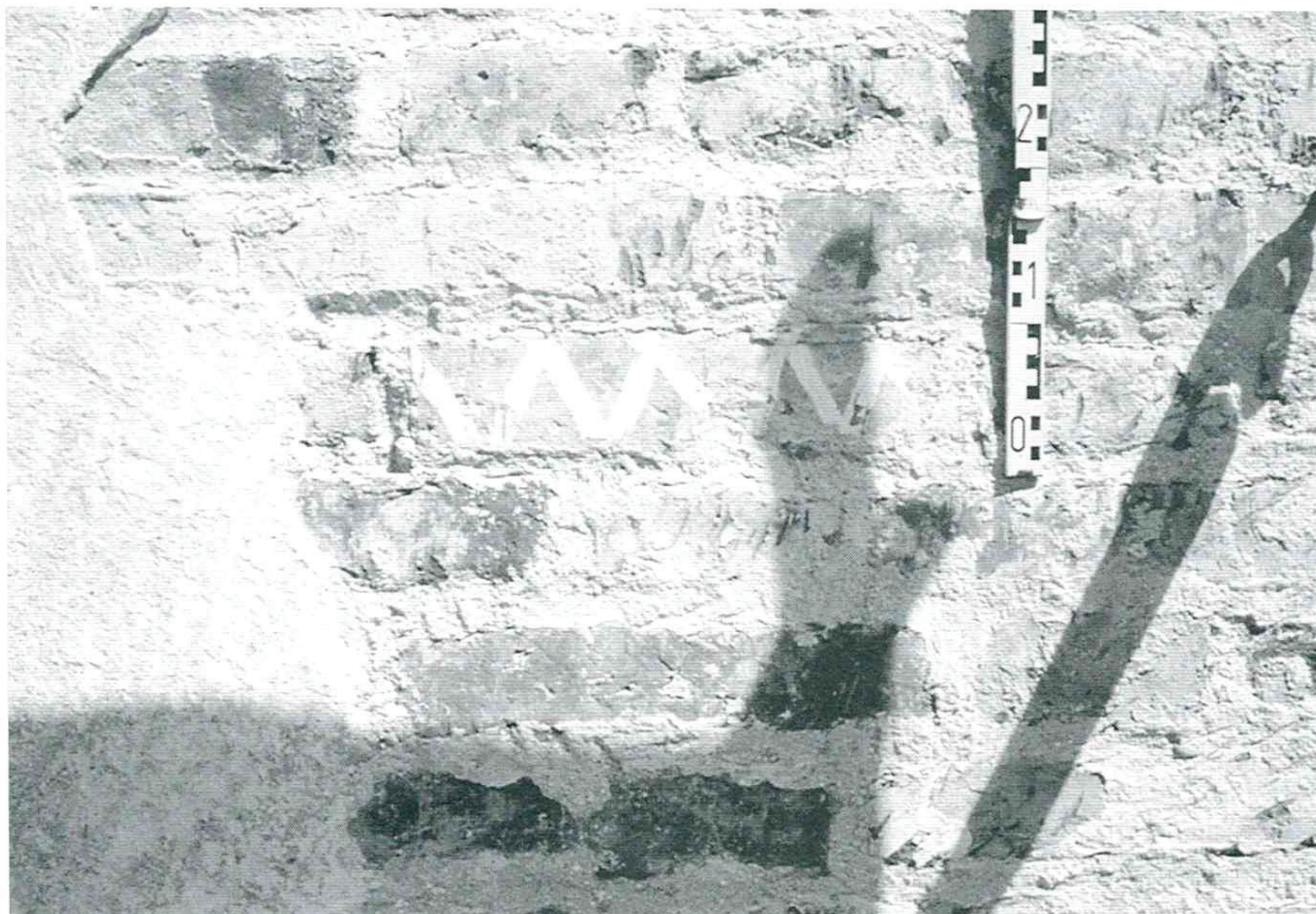
Abb. 8: Bachling – St. Stephan. Altarraum-Südwand. Sekundär verwendeter romanischer Ziegel mit Zick-Zack-Muster im gotischen Mauerverband; links daneben der einzige flächig erhaltene gotische Wandverputz.
